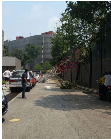
Kemalangan kren menara jenis luffing di Bangsar
