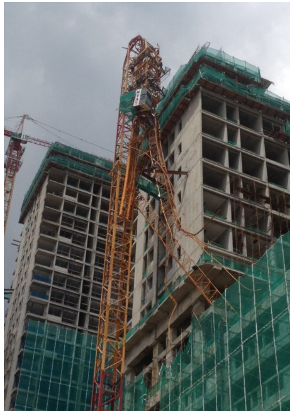
Keadaan kren menara selepas kejadian
