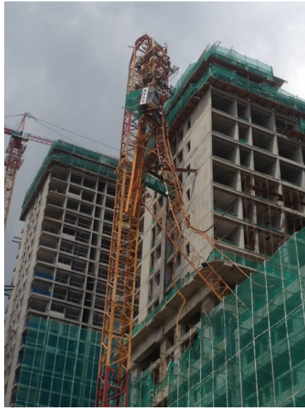
Rajah 10.7 Keadaan kren menara selepas kejadian
