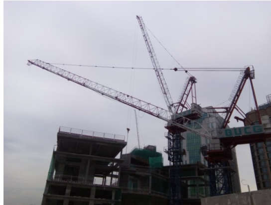
Rajah 6.7 Bongkah cangkuk daripada kren luffing yang menghempap kereta
