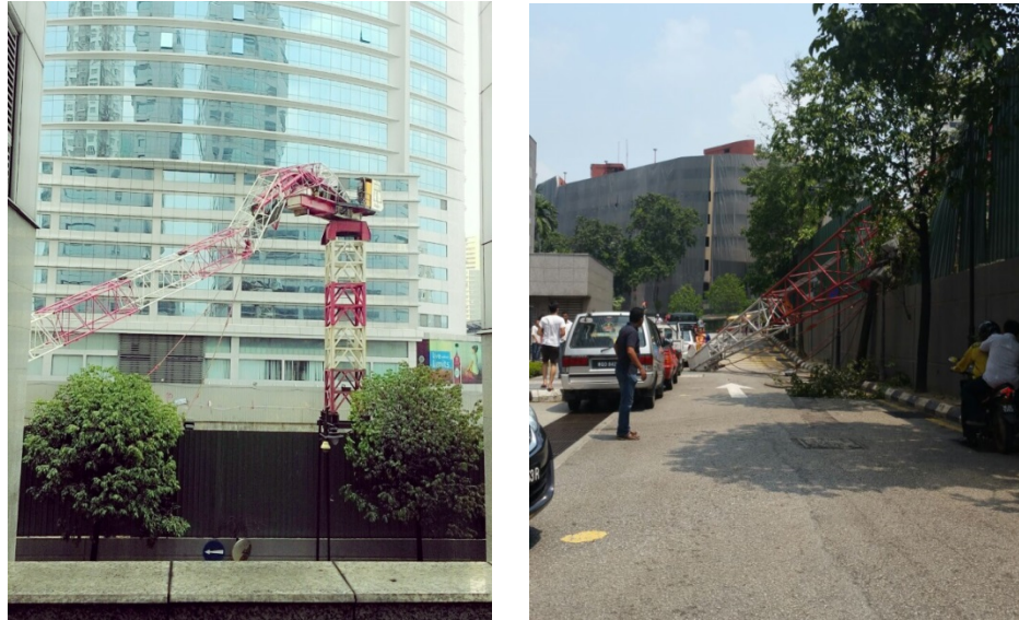
Rajah 6.5 Kemalangan kren menara jenis luffing di Bangsar
