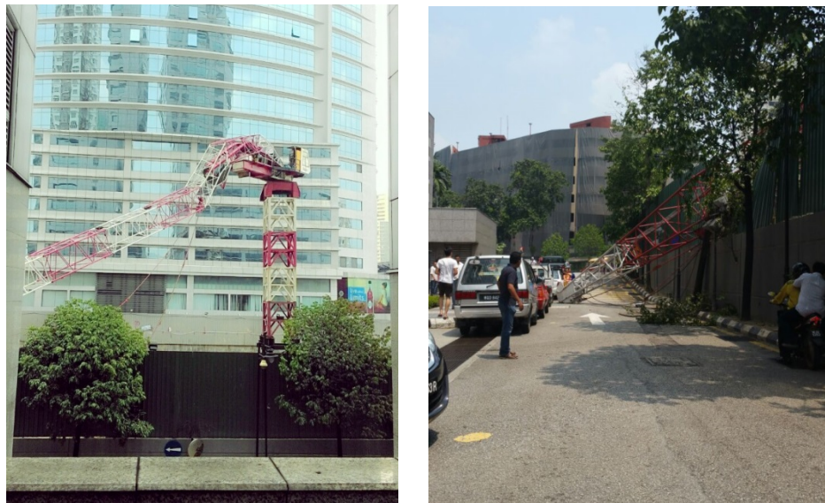
Rajah 4.6 Kemalangan kren menara jenis luffing di Bangsar
