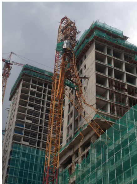
Rajah 4.7 Keadaan kren menara selepas kejadian
