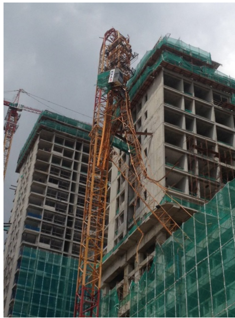
Rajah 10.20 Keadaan kren menara selepas kejadian
