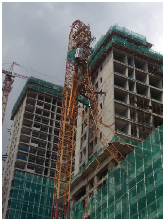
Rajah 9.9 Keadaan kren menara selepas kejadian
