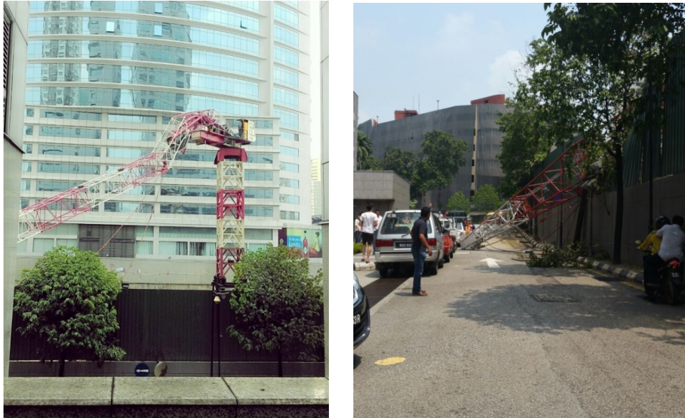
Rajah 12.9 Kemalangan kren menara jenis luffing di Bangsar
