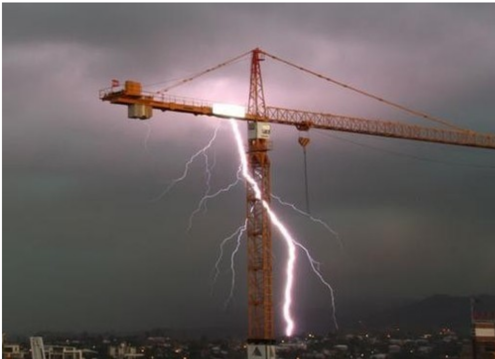
Rajah 7.1 Kren menara yang dipasang dengan alat penangkap kilat
