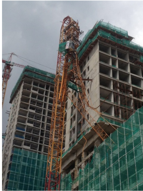
Rajah 12.10 Keadaan kren menara selepas kejadian
