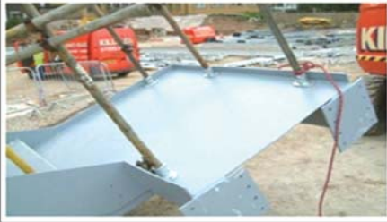
pegang tangan sementara dipasang di aras tanah (lubang yang sama kemudian digunakan untuk pegang tangan tetap)
