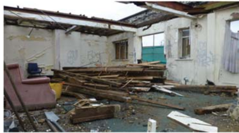
Perobohan telah dilakukan dengan tangan dengan pekerja memanjat ke bumbung tanpa mengambil kira keselamatan. Imej: HSE
