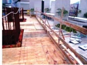
Platform kerja yang disediakan untuk kerja pemasangan keluli pada ketinggian (di atas 2m)
