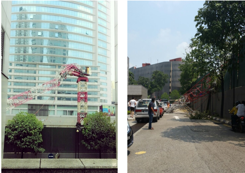
Rajah 4.8 Keadaan kemalangan kren menara di Bangsar
