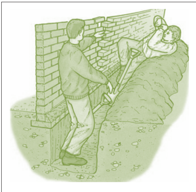
Rajah 3. Kestabilan struktur yang bersebelahan atau di kawasan yang akan dikorek mestilah dilindungi. Sekiranya terdapat apa-apa persoalan berkenaan kestabilan struktur yang bersebelahan atau di kawasan yang akan dikorek, struktur tersebut hendaklah disokong, sekiranya perlu, dengan sokong bawah cerucuk kepingan, penyangga, perembatan atau kaedah lain yang dibuat atau dibina mengikut reka bentuk Jurutera Profesional untuk mencegah kecederaan kepada mana-mana orang.
